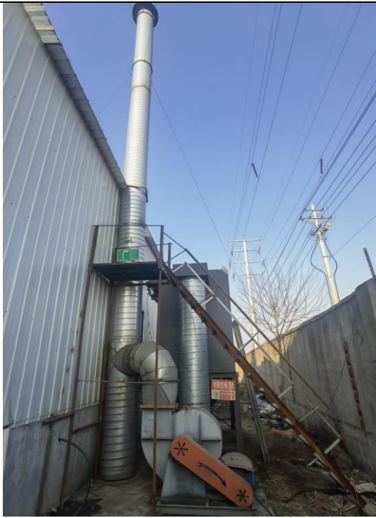
图 1 整改后的废气检测平台
